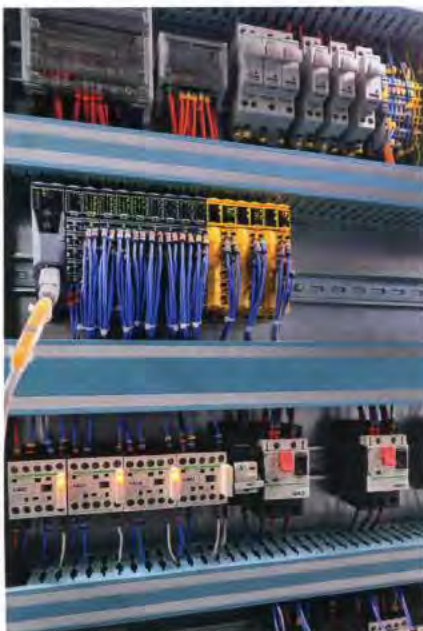
Vue partielle d'une armoire de commande de machinerie AMG Féchoz
