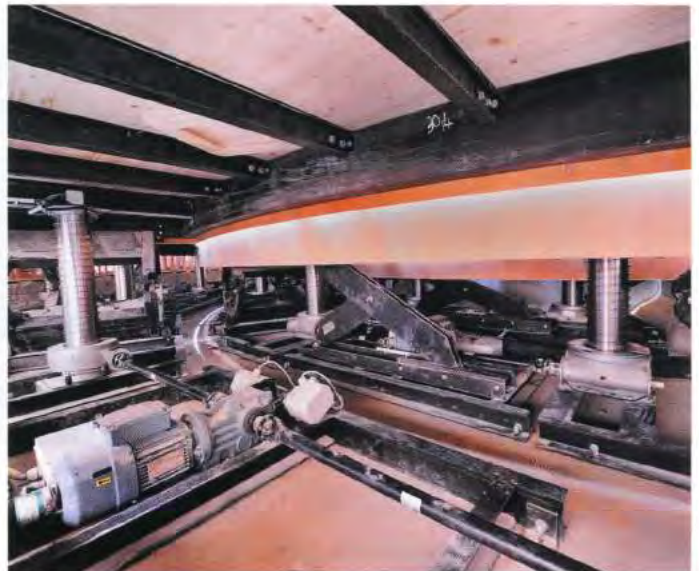
Motorisations des gradins d'orchestre AMG Féchoz (à base de Spirallifts)
