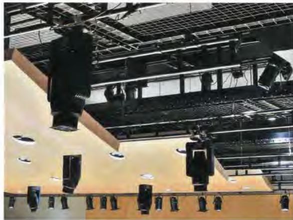
Réseau de passerelles avec ses projecteurs appuyés en position focus lumière
