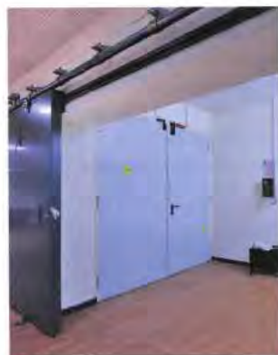
Porte coulissante coupe-feu (protégeant le monte-piano)
