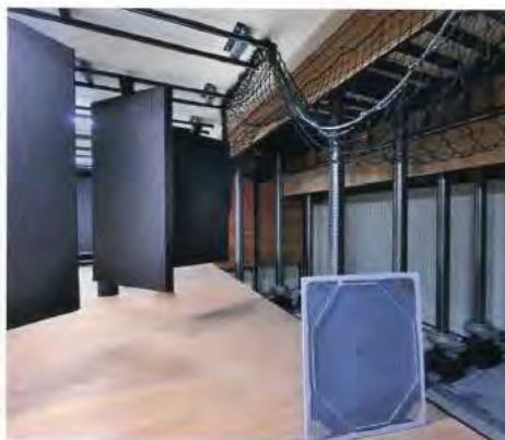
Panneaux acoustiques coulissants de la fosse d'orchestre
