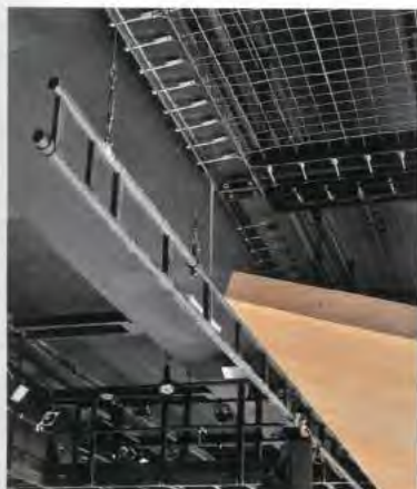
Passage étroit de la porteuse d'une équipe électrique, entre la gaine de ventilation et le réflecteur
