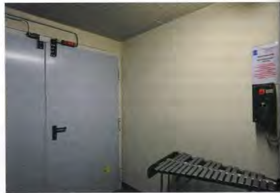
Portes du monte-piano au niveau R - 1, commande murale, capteurs de sécurité des portes
